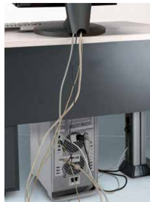
Sin organizador de cableado
